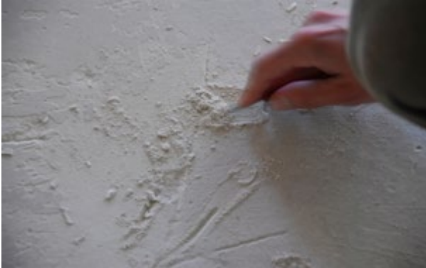
Labile Oberfläche in einem Calciumsulfat-Estrich
