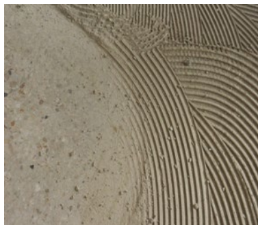
Teilweise abgeschliffener Fliesenklebstoff
